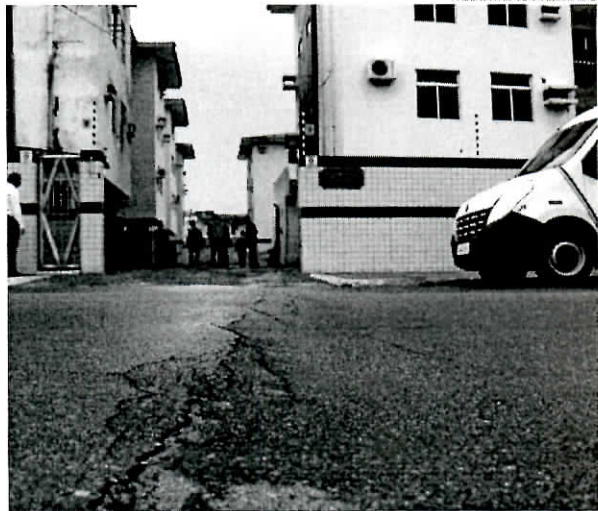
Condomínio Espanha já foi totalmente evacuado; prédios apresentam rachaduras e afundamento do piso
