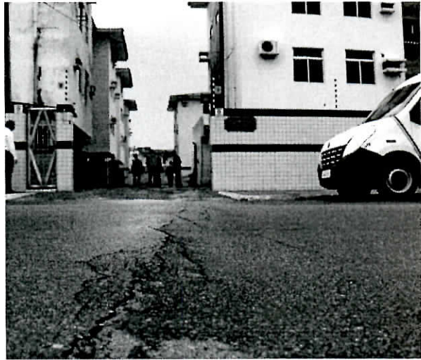
Condomínio Espanha já foi totalmente evacuado; prédios apresentam rachaduras e afundamento do piso
